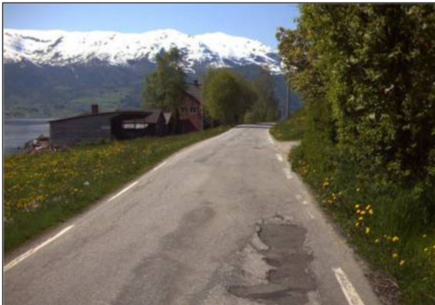
Bilete 3: Skadd vegdekke p  den l gtrafikkerte fv. 700 n r Sandane (foto: Statens vegvesen).
