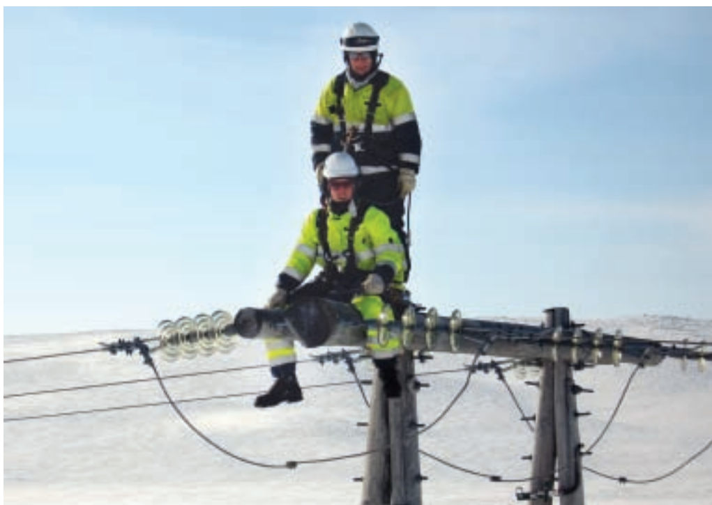
Toppbefaring 66 kV. Linje Sautso-Kautokeino
