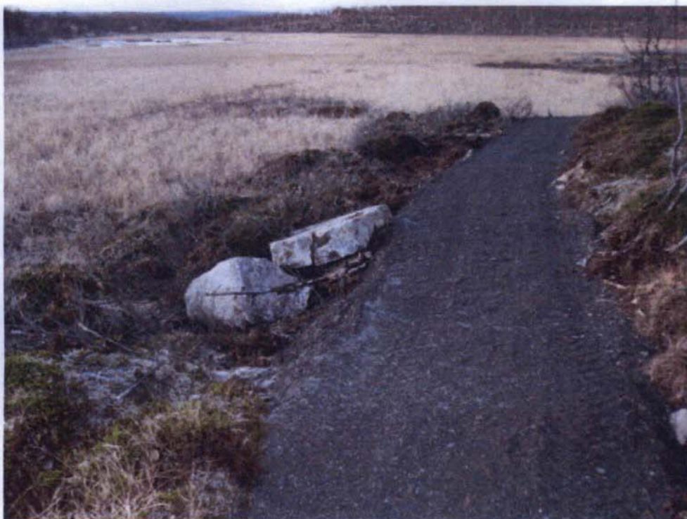
Figur 4 Bildet viser hytteveien etter siste bro. Viser 2 steiner som er flyttet til siden.
