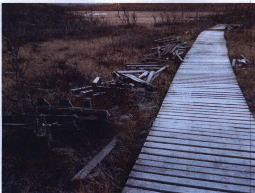
Figur 8 Bildet viser bru nr. 2 med forsøpling.
